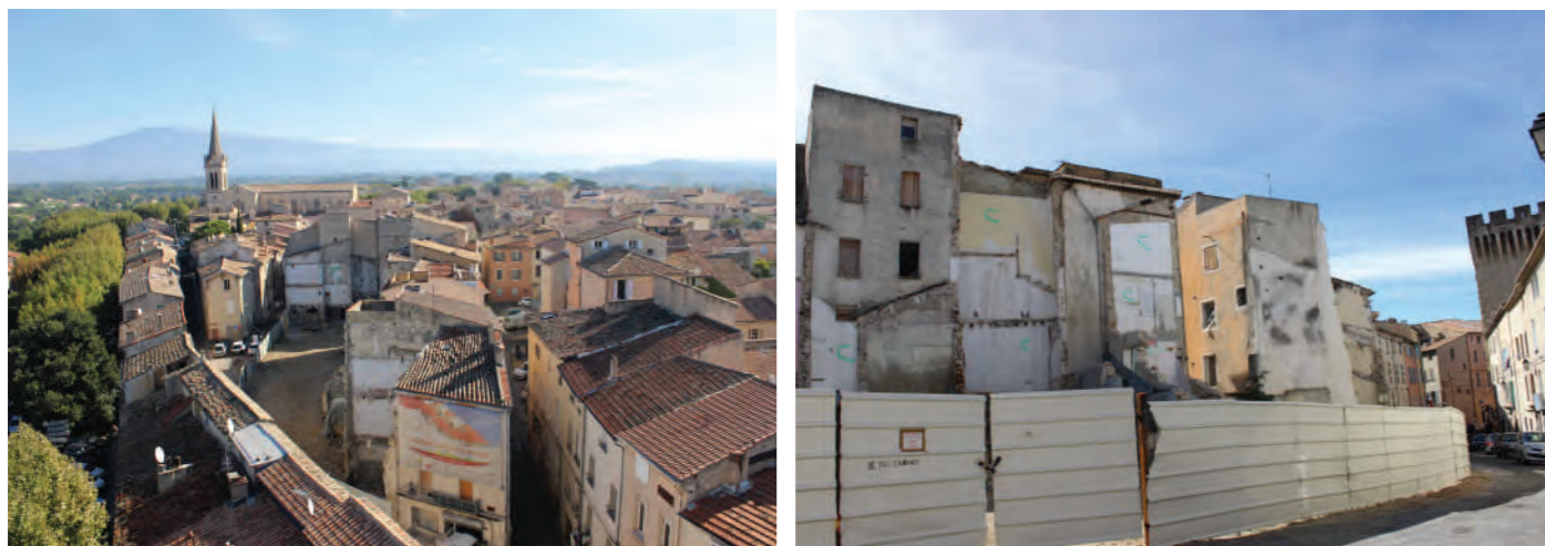
Réhabilitation en cours en cœur de ville, îlot Mouton dans le cadre du PNRQAD. Démolition partielle et reconstruction de l'îlot. Création de cours intérieures.
