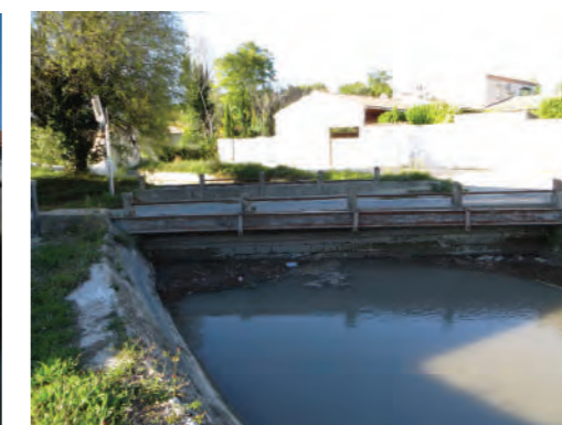
Les ajouts et constructions peu soignées nuisent à la qualité de l'ouvrage hydraulique.
